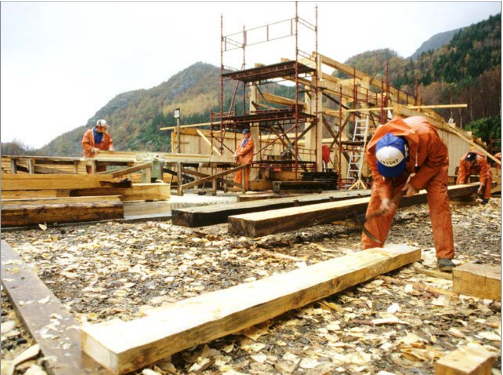
Veggene i Gildehallen ble reist på en syllstokk av eik for å motstå fuktighet og råte. Foto: Åge Pedersen.
